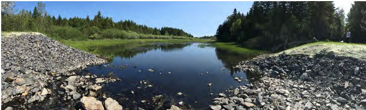
FIGURE 84 - TRAVAUX DE RESTAURATION DU MARAIS DE LA MEDER FINANCÉ PAR LE PRMCHH
